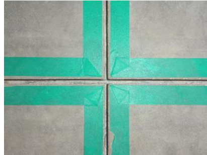
目地底に誘導したひび割れ
