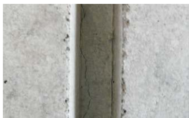
写真1 目地内のひび割れ
