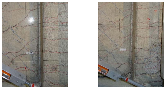
図4 R=-1.5\% 時1層目引張側目地周辺状況
